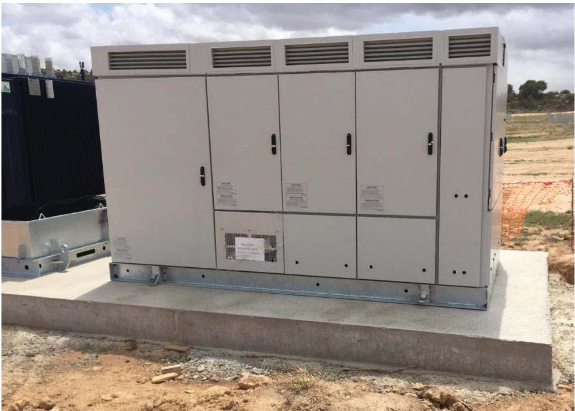
Imagen 1. Estación de potencia.
